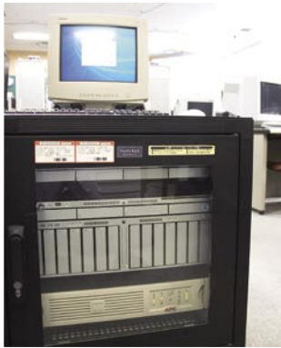
研修室後方のサーバラックには、Xserve、Xserve RAIDとUPSが入っており、Xserve RAIDやUPSの設置・設定の仕方が学べるようになっている。
